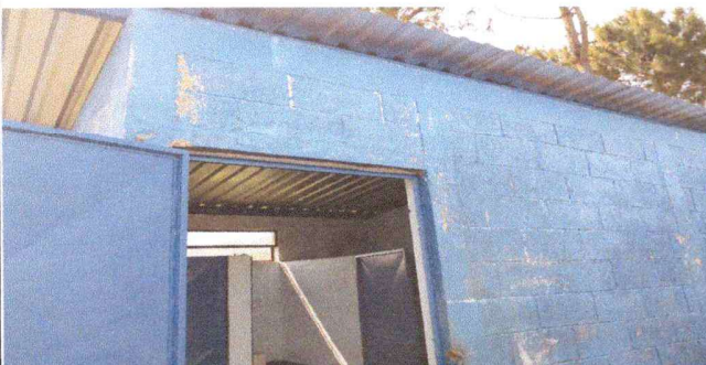
Foto 5: Baño: Puertas y pintada en el interior.
