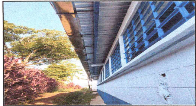
Foto 4: Cocina: Láminas dañadas y estructura de madera.
